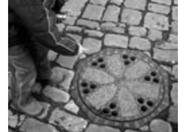
Kein Plazet in den Augen des Fachmanns, Prof. Gullio: Rosettenkanaldeckel mit Segmentfüllung aus Asphalt mitten im hochwertigen Kopfsteinpflaster des Weltkulturerbes.
